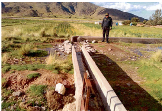
Foto 3: en la foto se observa, este hecho fue denunciado a la Comisaría del distrito de Cabanillas, los cuales vienen constataando el hecho causados por BENIGNO CONDORI NINA
