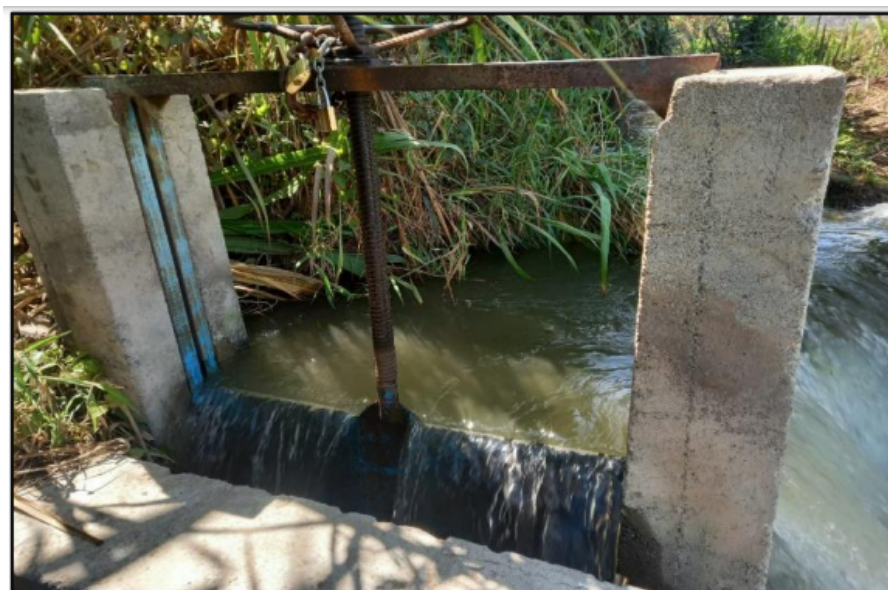
Fotografía del Informe Técnico N° 0043-2022-ANA-AAA.CHCH-ALA.P/LCDL (Fuente: JUSHMP, donde se muestra la compuerta levantada)
